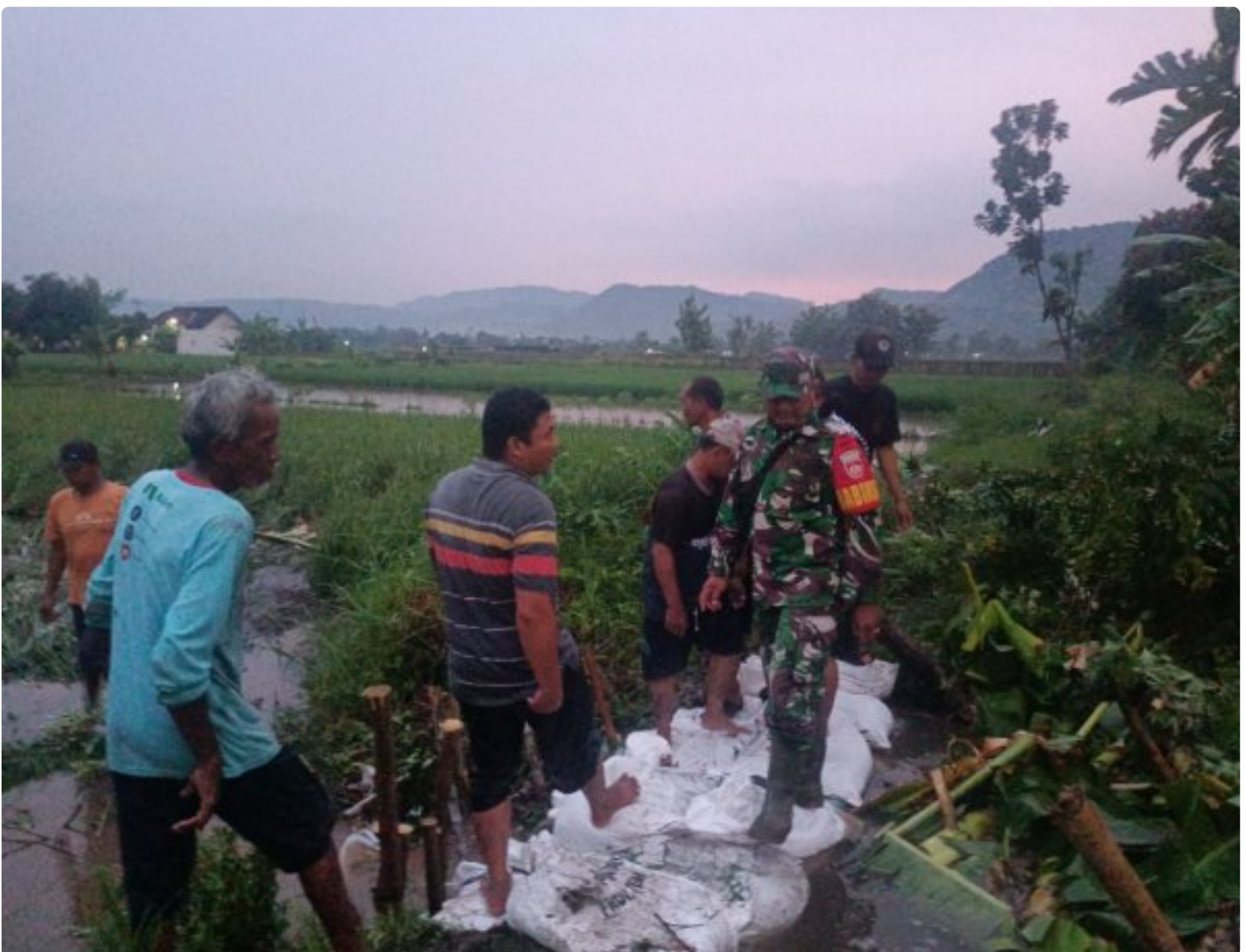
Tanggul Sungai Kongklangan Jebol, Babinsa Koramil Prambanan Klaten Bersama Warga Cepat Tanggapi Kejadian
