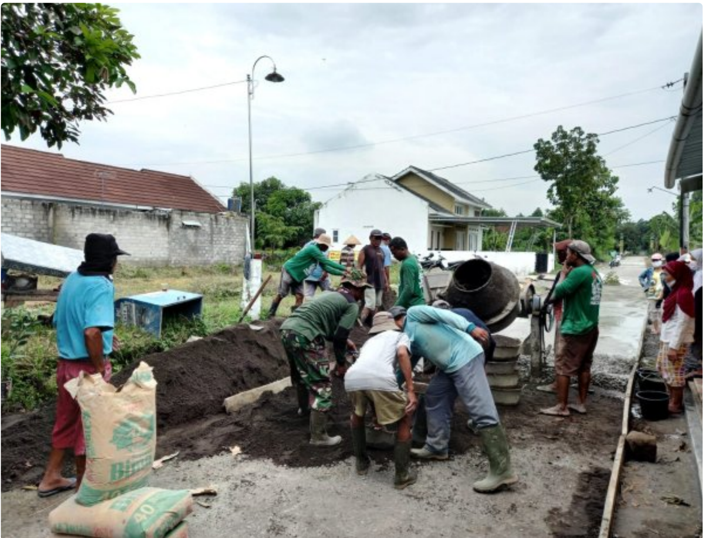
Serka Tenang Suseno, Babinsa Desa Muruh Gantiwarno Klaten Bersama Warga Lakukan Betonisasi Jalan Kampung
